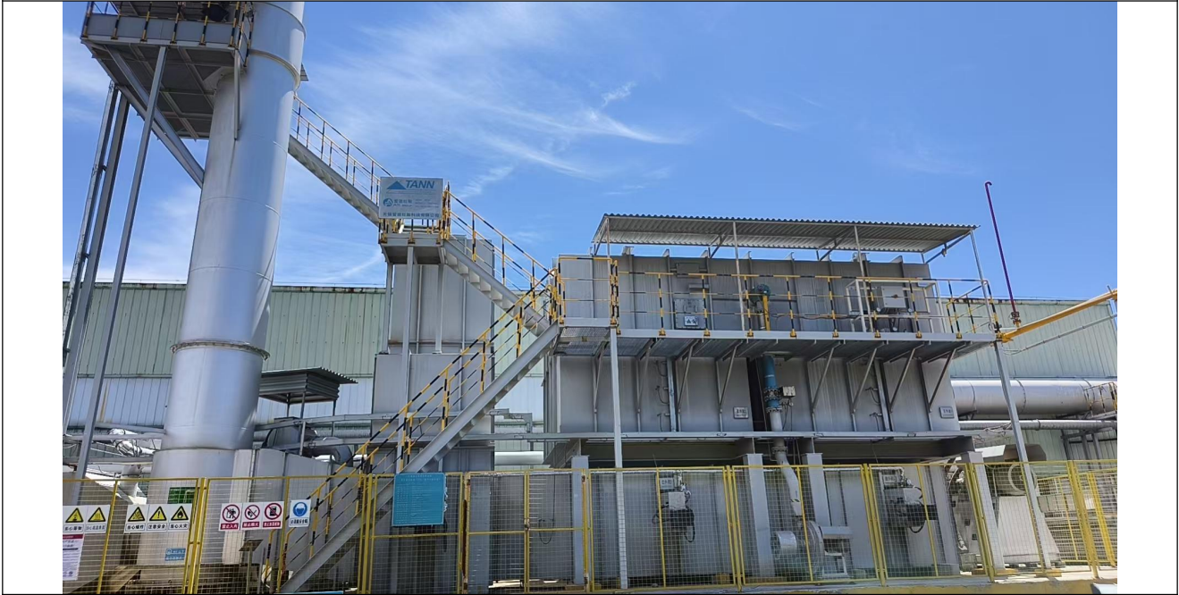
活性炭吸附/脱附+RTO 环保设备+排气筒
