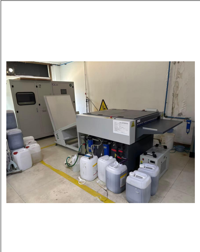
冲版废水、显影废液处理系统
