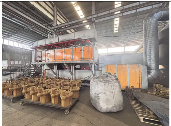
干式过滤+活性炭吸附脱附+蓄热式催化燃烧装置
