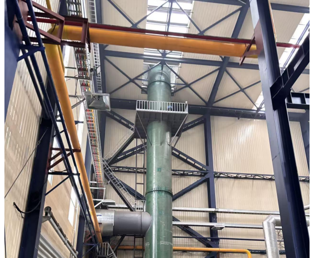
排放口及采样平台
