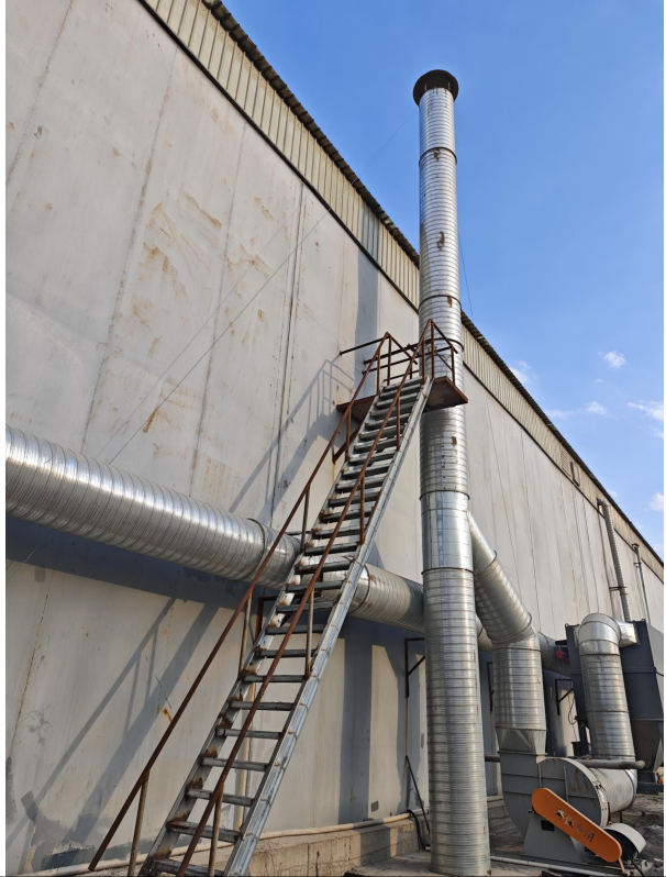
检测口及采样平台（DA002）
