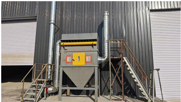
袋式除尘器及采样平台（DA001）
